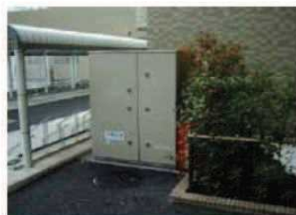
a. 自家用受変電設備例
