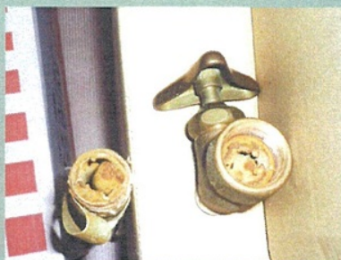
③ 給水管と止水栓の腐食状況 (内視鏡調査時にネジが折れて しまったケースもあります)
