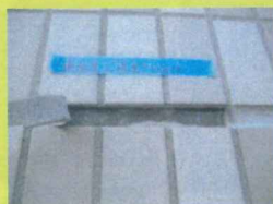
シーリング劣化試験
